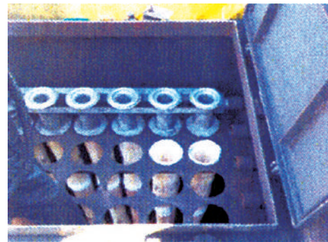
ブレスフィルター+ TCI+Cシステム設置
